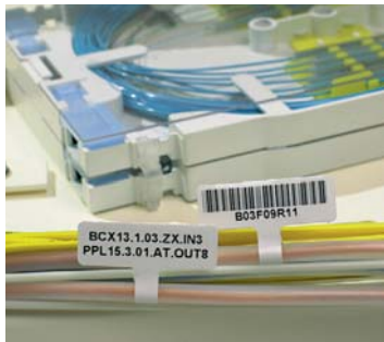
Fähnchen für Glasfaserkabel
