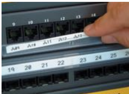
Labels voor patchpanelen
