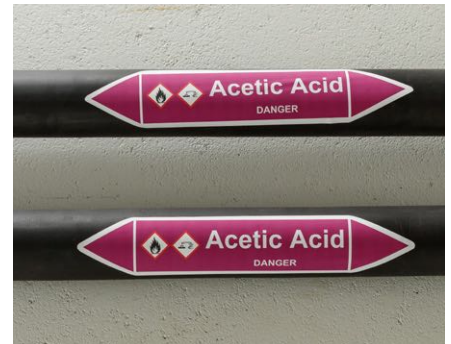
Marquage de tuyauterie
