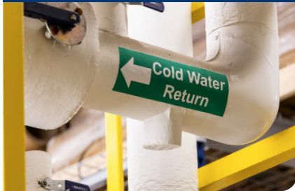
Marcadores de tuberías
