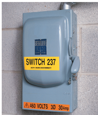
INTERRUPT- TEUR 237 ACP-1 DÉCONNEXION PRINCIPALE
