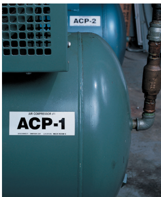
COMPRESSEUR D'AIR N° 1 ACP-1 DÉCONNEXION : INTERRUPTEUR 237
