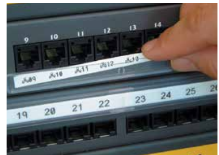
Labels voor aansluitklemmen en patchpanelen
