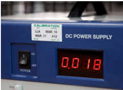
Étiquettes de maintenance
