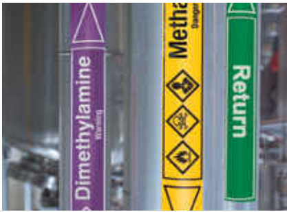
Marquage de tuyauteries et de vannes
