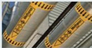
Marcado de Tuberías
