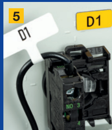
5 Banderas de cables
