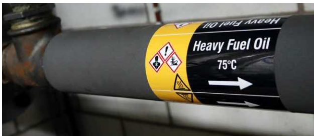
Marqueurs de tuyauteries conformes à la norme ISO 20560 : pages 9-17
