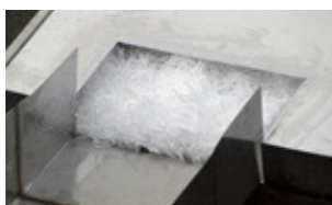
Filtrage des eaux usées avant déversement dans la zone d'évacuation de l'eau.
