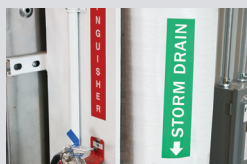
Marcadores de tubería
