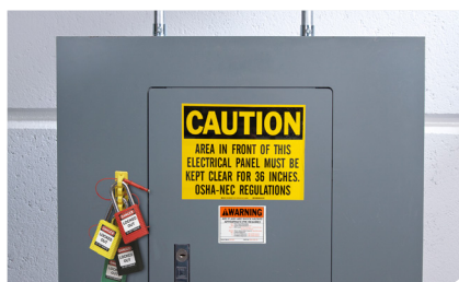
Identificación de paneles y gabinetes
