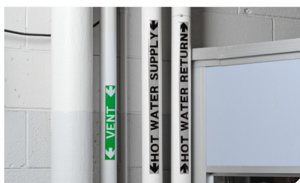
Marcadores de tuberías
