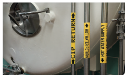
Marqueurs de tuyauteries
