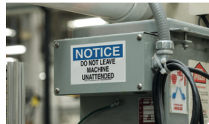
Panneaux de sécurité
