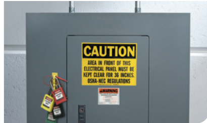
Identification de tableaux et de coffrets électriques
