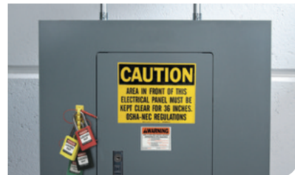
Schalttafel- und Gehäusekennzeichnung
